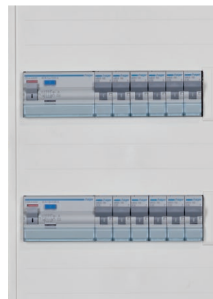
Abb. 3: FI-Schutzschalter mit sechs 1-poligen LS-Schaltern
